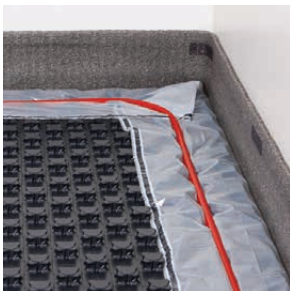
8. Detail pokládky trubky RAUTHERM S u stěny.
