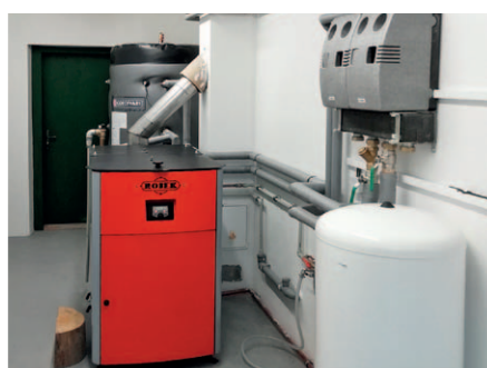
Vzorová kotelna s kotlem ROJEK PK BIO
